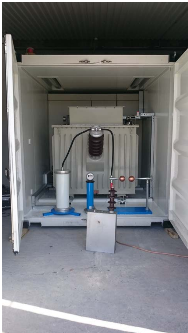
Высоковольтный отсек с резонансным трансформатором, делителем напряжения, шаровым разрядником и блоком выпрямленного напряжения
