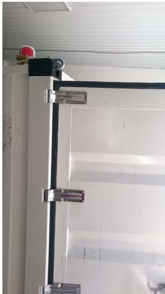
Сигнальная лампа при проведении высоковольтных испытаний
