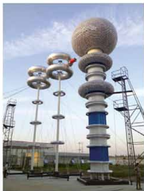
Система испытания изоляции электрооборудования с большой электрической емкостью
